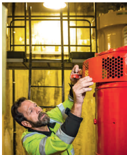
Franz Baumann kontrolliert die Hydraulik-ölpumpe des «Schiebers» (Notablass des Stausees).
