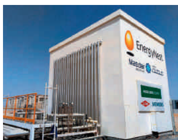
Ein erster Prototyp des Betonspeichers steht im Öko-Stadtprojekt Masdar City bei Abu Dhabi.
