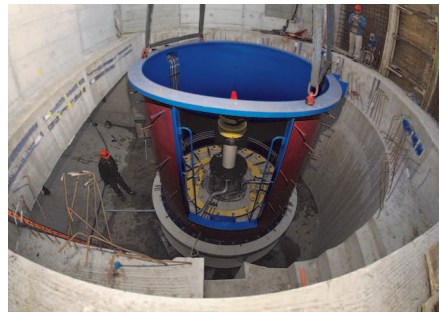
Leitapparat mit Turbine
