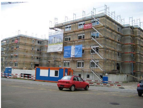
Die Rohbauten der beiden MFH im September 2010 beim Grünauring in Luzern (vormals Littau).
