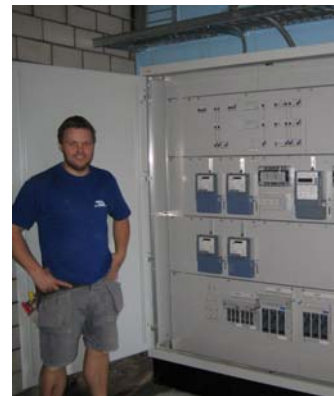
Teamleiter Thomas Hoesli bei der Inbetriebnahme.
