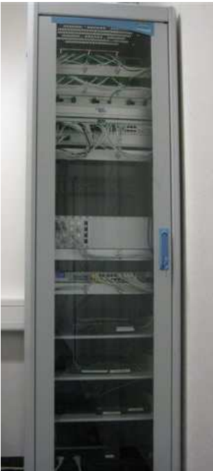
Kommunikationsschrank am Hauptsitz in Malters
